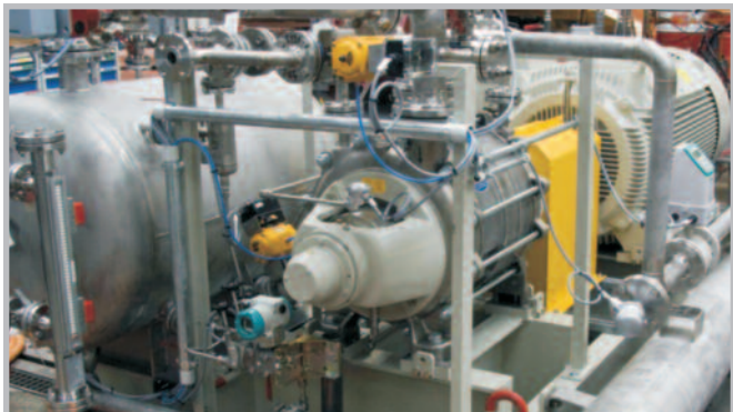
Sistema de compressão de ozônio com compressor NASH 2BG
