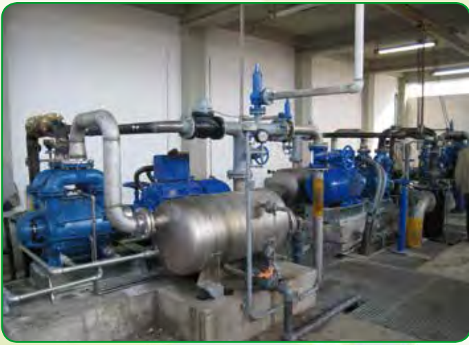
Kompressorenaggregate CRVS für den BIOGAS -Kreislauf im Fermenter.
