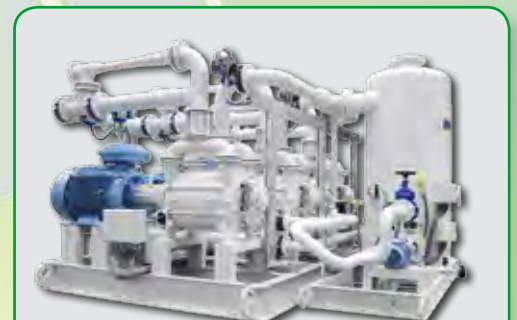
Heizkraftwerk mit Dampfturbinen: Vakuumeinheit zum Leeren des Kondensators.
